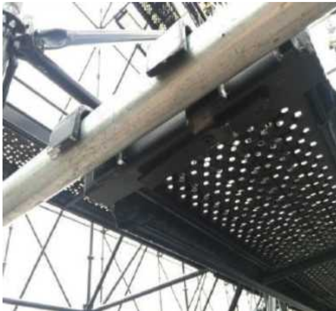
작업발판 이탈방지조치 미설치(설치 상태 미흡)
