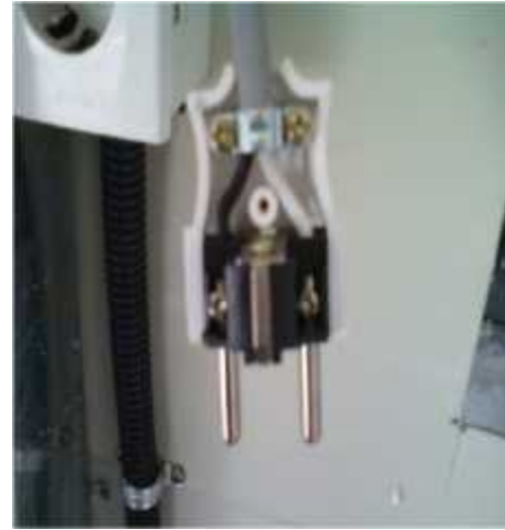
접지극 플러그 접지 미결선으로 인한 감전 및 누전차단기 부작동 가능(미흡)
