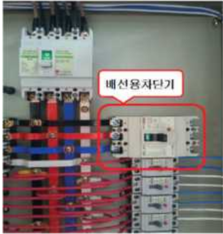
배선용차단기 사용으로 누전에 의한 감전 및 지락사고 보호 불가(미흡)
