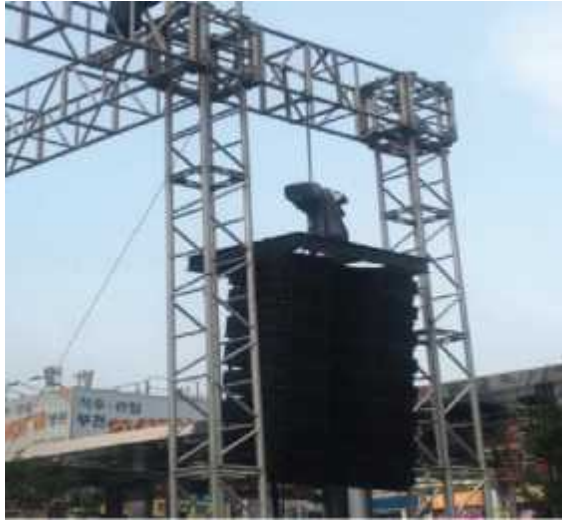
상부 고정에 의해 음향장치가 흔들리거나 회전가능(설치상태 미흡)
