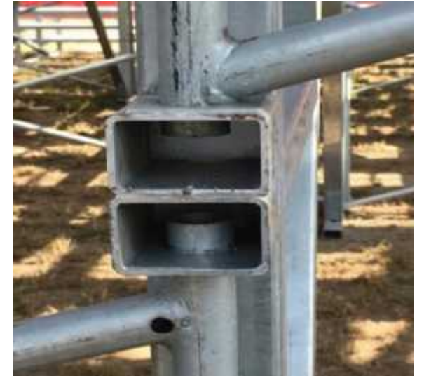
비계 구조물 수직재 간 연결 상태 미흡
