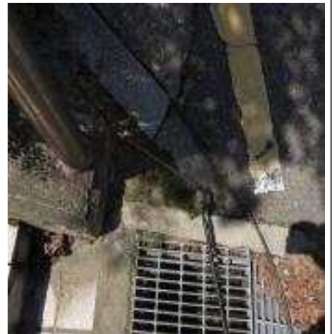
발전용 차량의 접지봉이 올바르게 설치되지 않음(미흡)
