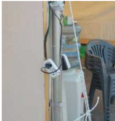
외부에 노출된 콘센트의 방수조치 미실시로 감전사고 우려(미흡)
