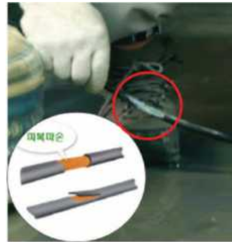
전선 피복 손상으로 인한 감전사고 발생 우려(미흡)
