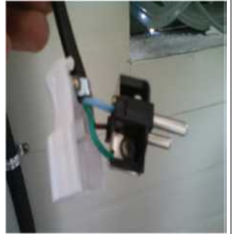
접지극 플러그 접지 실시로 인한 감전사고 예방(양호)
