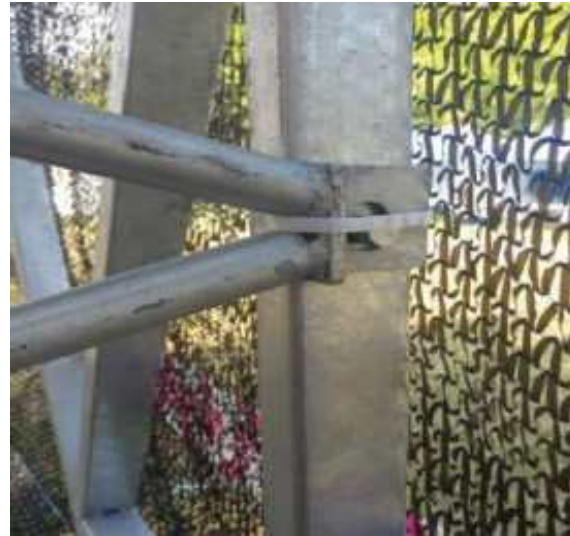
비계 구조물 체결 시 케이블 타이 사용(설치 상태 미흡)
